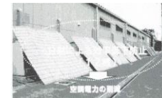
空調室外機 遮熱
