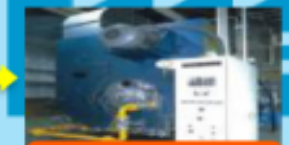
既設ボイラー
